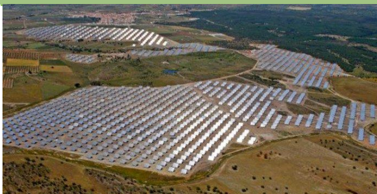
Figura 116. Central Solar Fotovoltaica de Amareleja. Fonte: Portal Energia.
