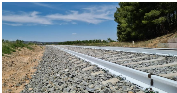
Figura 140. Exemplo de medida testada em Espanha para evitar a deformação dos carris com temperaturas elevadas (aplicação de tinta branca).
